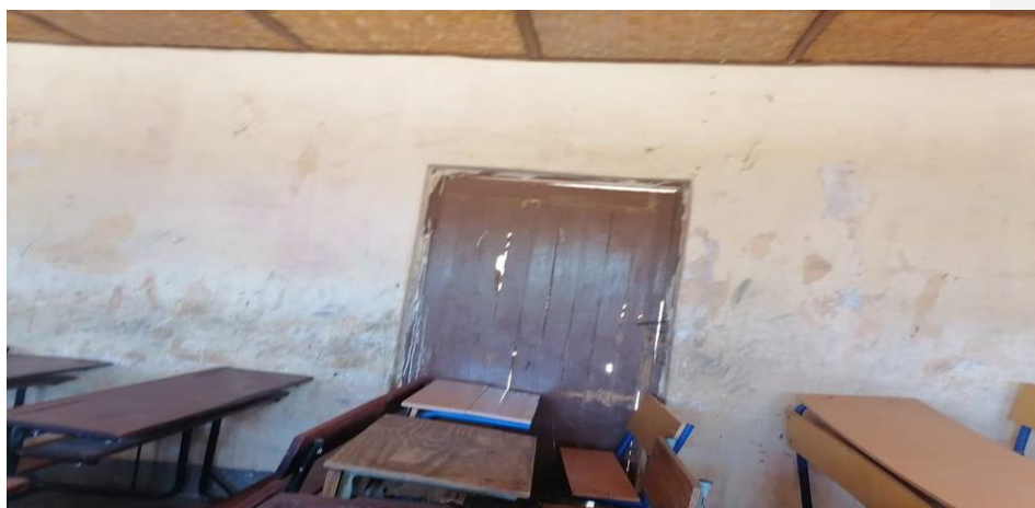
Interior da Escola, porta interdita
